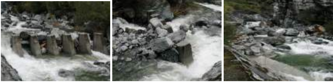
Alla foce del torrente poco a monte del ponte carraio in sinistra orografica, il muro di sponda ha ceduto formando un ampio antro. La fotografia sotto riportata descrive al meglio l'ampiezza del danno - Foto stazione forestale di Verres
